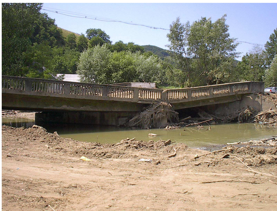
Fig. 3. Podul peste Valea Izvorului, din centrul localității Târlișua, distrus de viitură.
